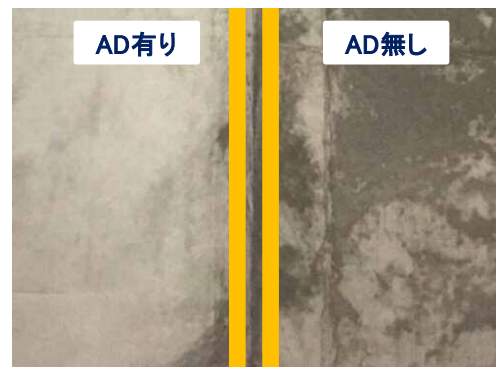
経年後のコンクリートの表面状況
