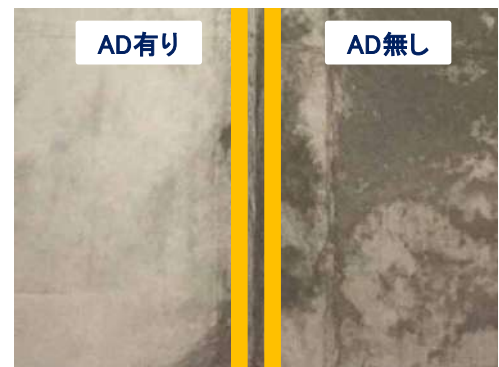
経年後のコンクリートの表面状況
